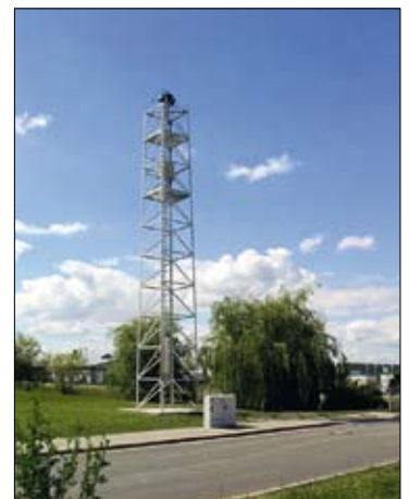
Funkturm im Gewerbegebiet.
